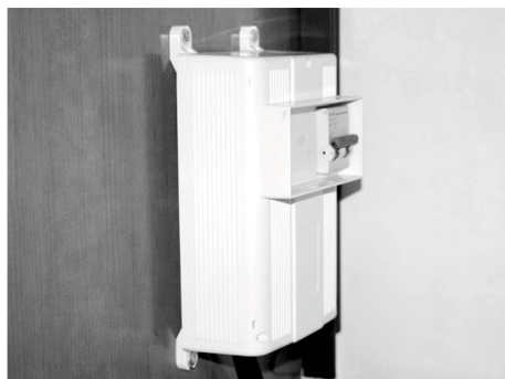
Fig. 57 : Interrupteur principal (disjoncteur différentiel)
