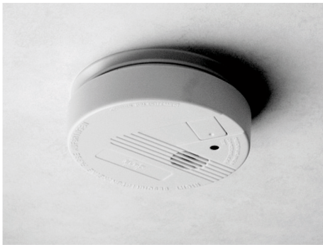
Fig. 41: Détecteur de fumée
