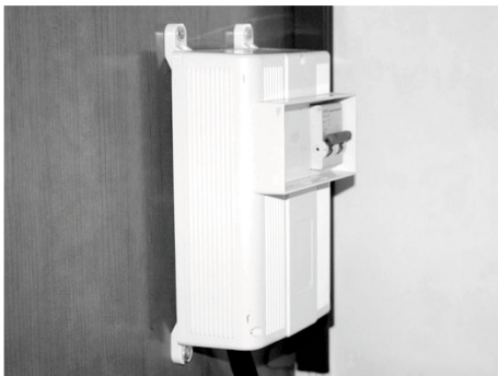
Fig. 3 : Interrupteur principal (disjoncteur différentiel)
