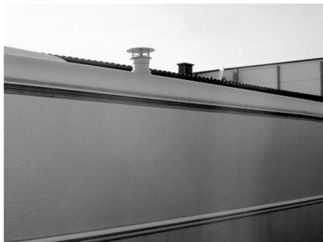
Fig. 89: Camino di scarico del riscaldamento a gas
